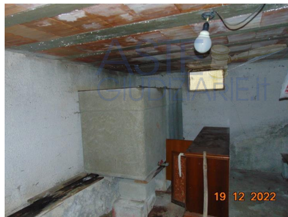
Interno cantina (manufatti in eternit)
