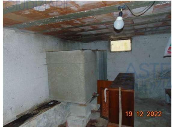
Interno cantina (manufatti in eternit)
