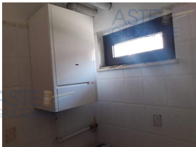
Dettaglio del bagno e della caldaia
