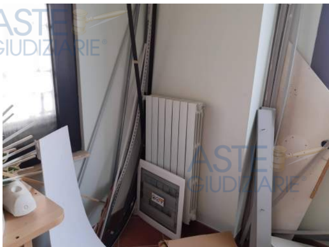
Dettaglio impianto riscaldamento
