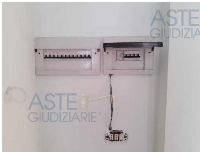
Dettaglio impianto elettrico
