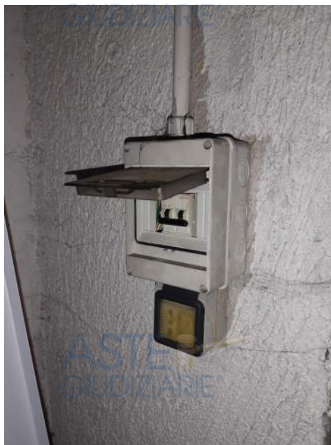
Dettaglio impianto elettrico
