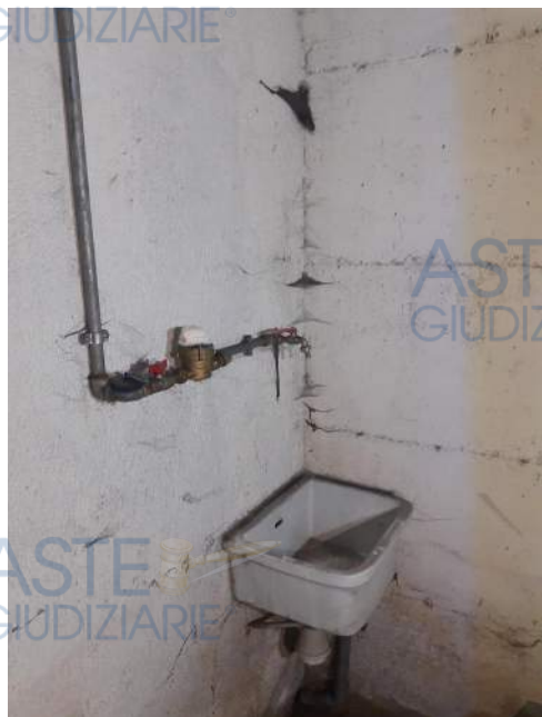
Dettaglio impianto idrico
