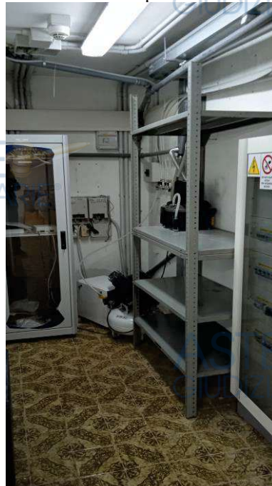
Foto locale impianti PS1
