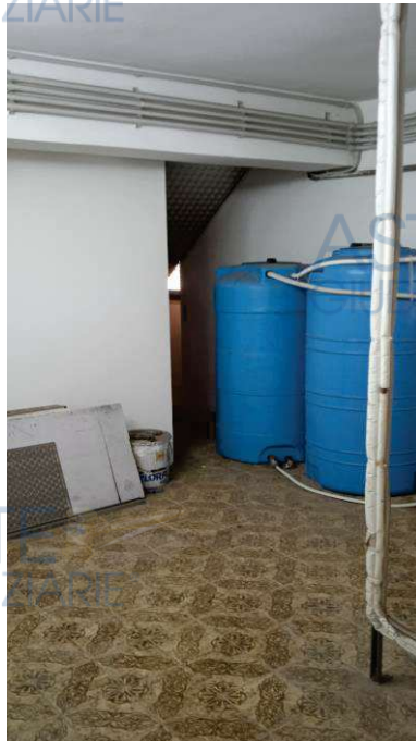
Foto locale tecnico PS1
