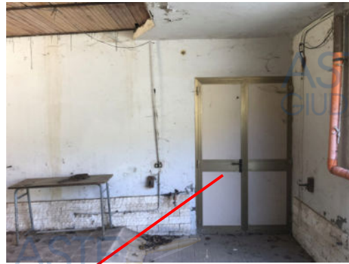
Uscita di sicurezza antincendio
