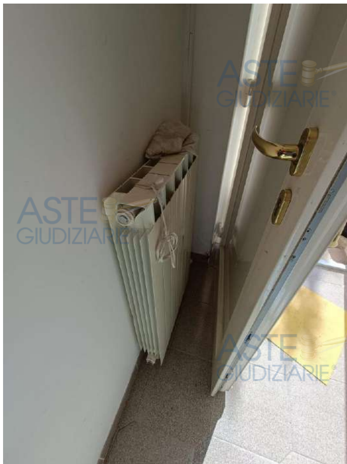
Figura 14 – Particolare Radiatori Piano Terra.
