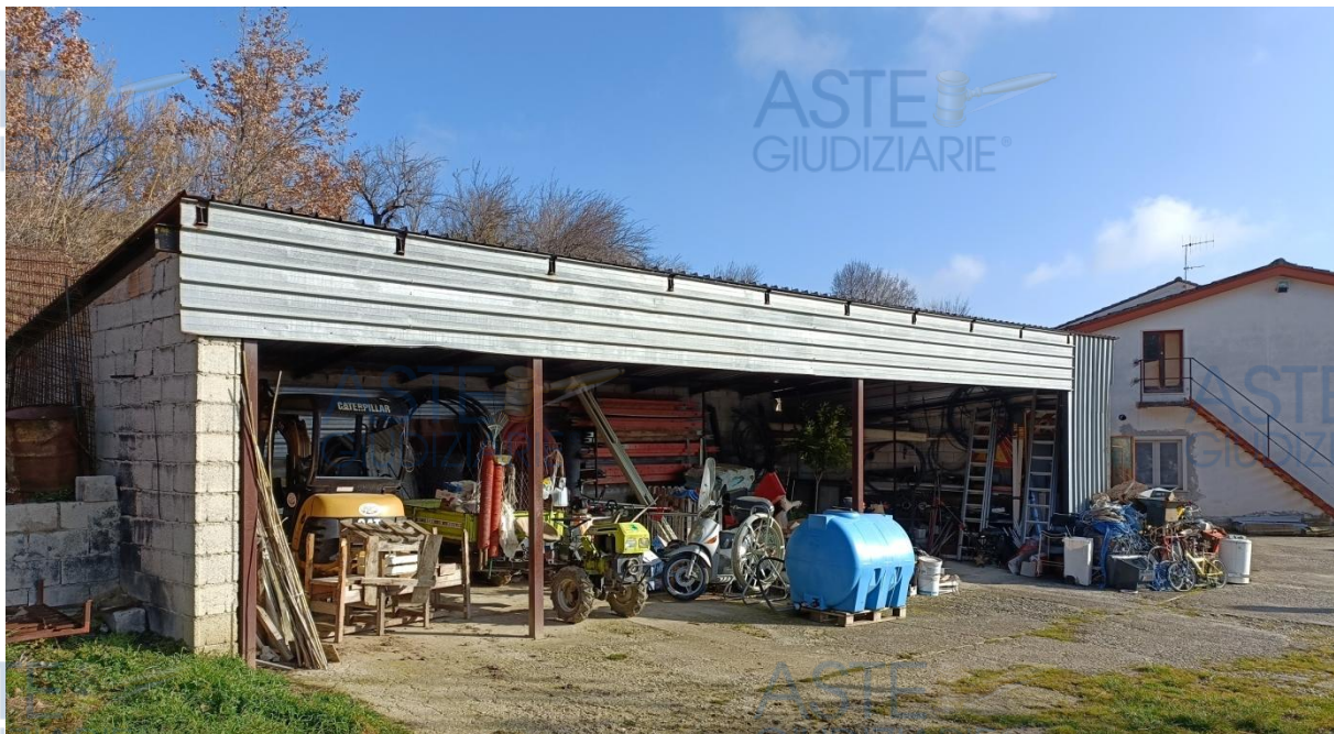
Figura 4 – Corpi di fabbrica realizzati in assenza di Titolo Abilitativo e non presente in Catasto.
