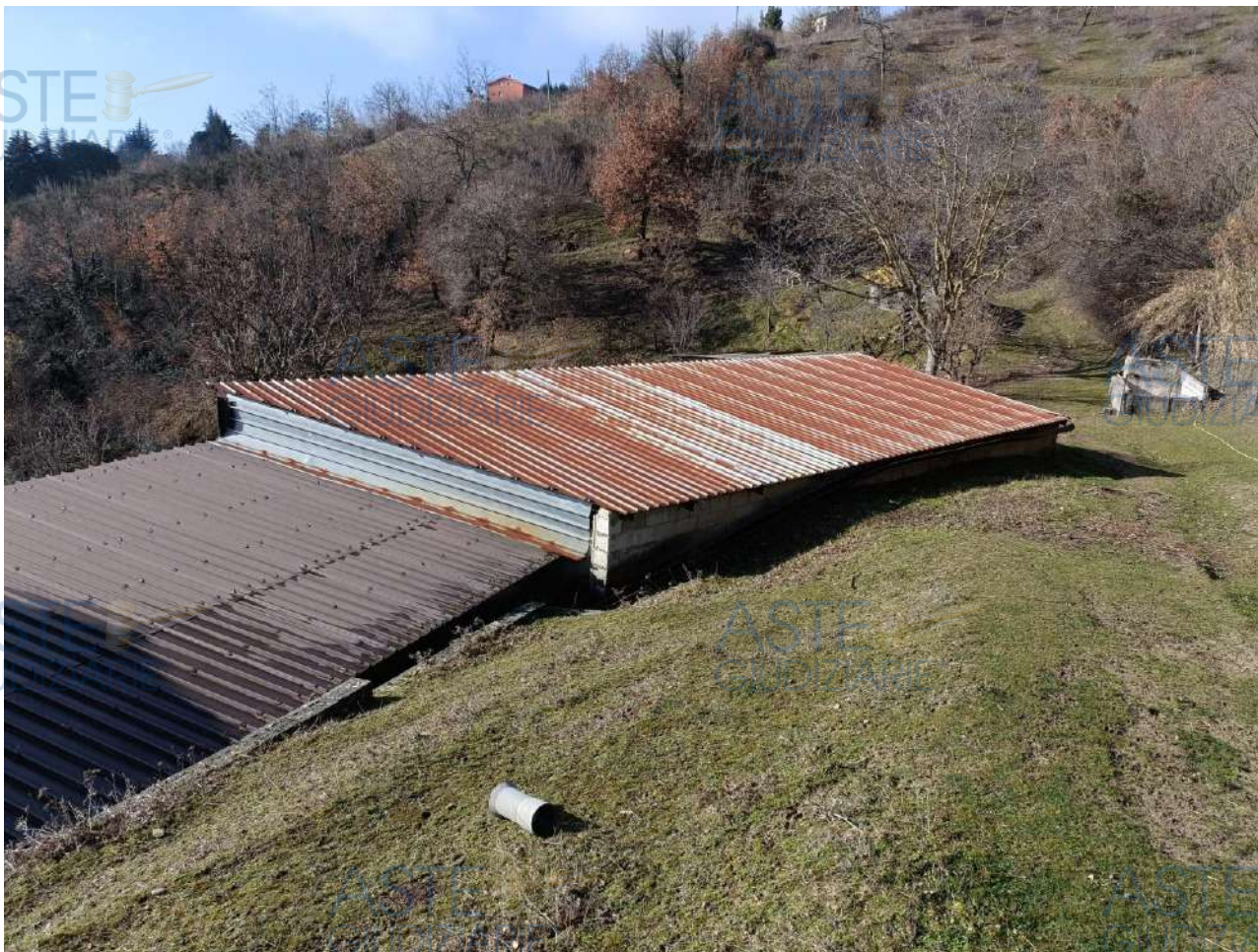
Figura 27 – Corpi di fabbrica realizzati in assenza di Titolo Abilitativo e non presente in Catasto.
