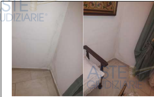
Piano terra – macchie di umido camera 1
