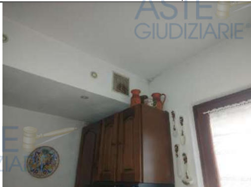
Piano terra – macchie di umido cucinotto
