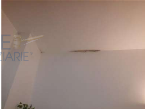
Piano terra – macchie di umido pranzo 1
