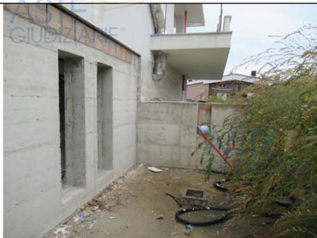
Foto n° 4 – Lotto n. 1 – Esterno a giardino vano piscina e aperture (variate rispetto al progetto approvato)
