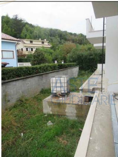
Foto n° 13 – Lotto n. 2 – Giardino retrostante, si nota il locale tecnico seminterrato da sanare.
