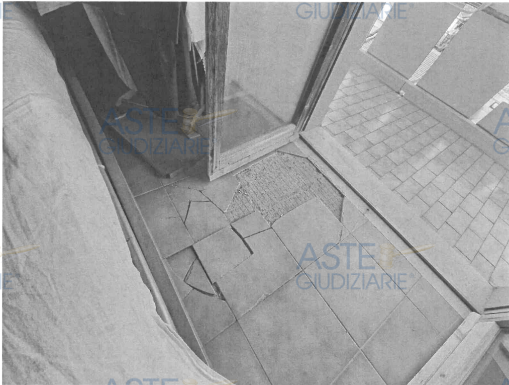
foto 5: pavimentazione mancante nella zona notte
