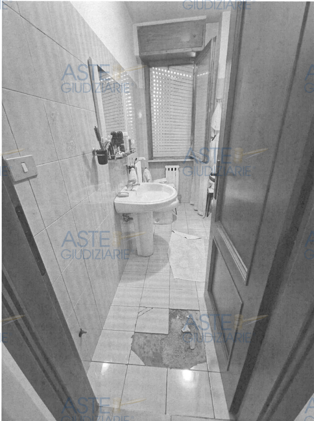
foto 6: pavimentazione mancante nel bagno
