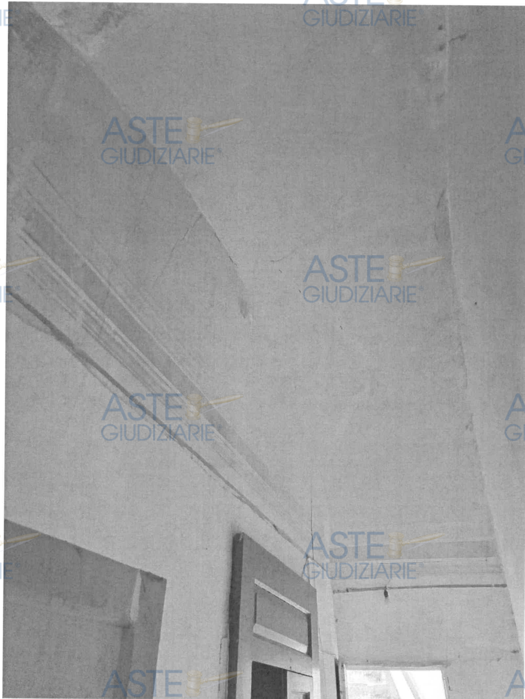
- Foto 12 – foto interna: lesioni
