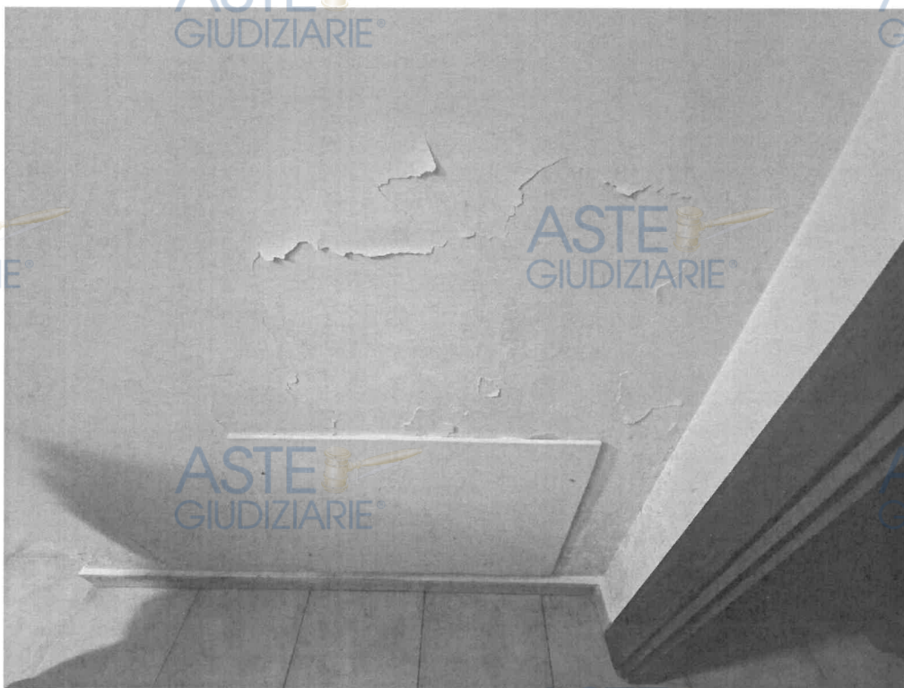
foto 1 : infiltrazione zona collettore
