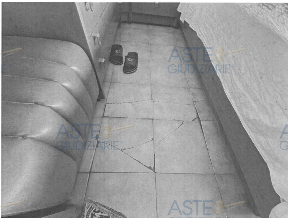
foto 4: pavimentazione lesionata nella zona notte
