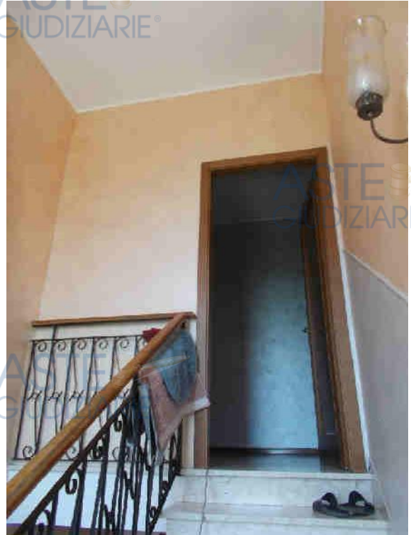
Foto 13- P. 1. - Ingresso abitazione (da sanare)
