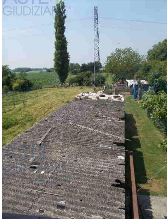
Foto 11- Annesso- deposito attrezzi- copertura in eternit
