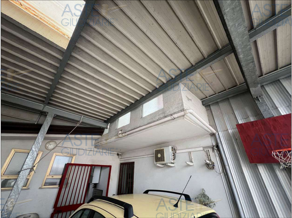
Vista dell'aggancio della copertura non autorizzata soprastante la corte interna con il terrazzo della camera a Nord.
