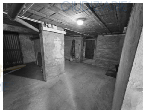
Locale comune ps1
