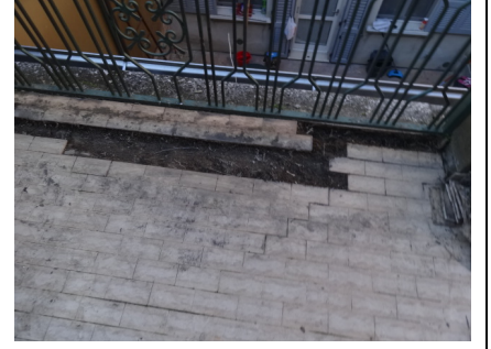
Sub 13, finiture e stato conservativo
