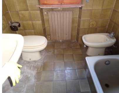
Sub 13, finiture e stato conservativo
