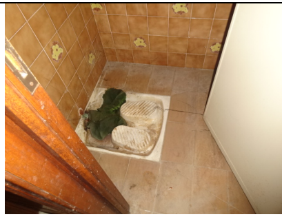
Sub 15, finiture e stato conservativo
