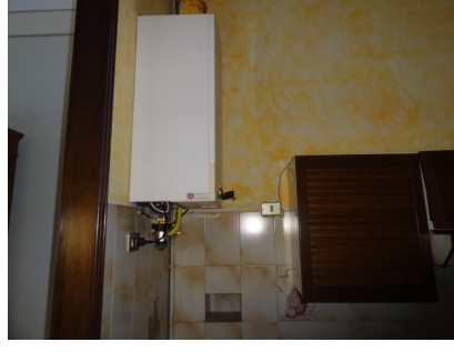
Sub 13, finiture e stato conservativo
