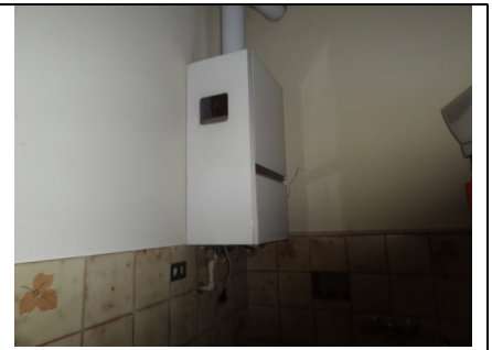
Sub 15, finiture e stato conservativo
