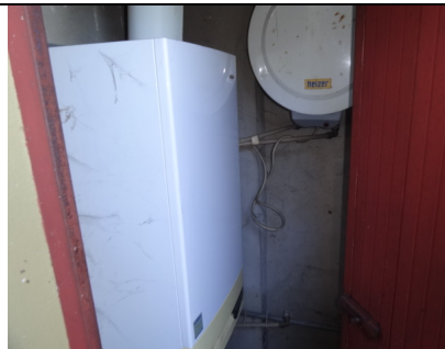
Sub 14, finiture e stato conservativo
