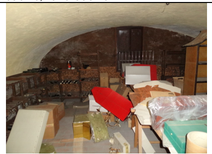
Sub 15, zona cantina
