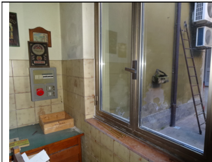
Sub 15, finiture e stato conservativo
