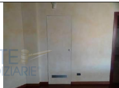
Finiture/dotazione impianti abitazione
