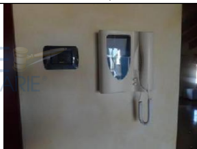
Finiture/dotazione impianti abitazione
