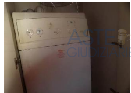
Finiture/dotazione impianti abitazione
