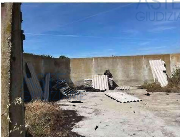
Figura 46 - silos orizzontale con smaltimento lastra copertura
