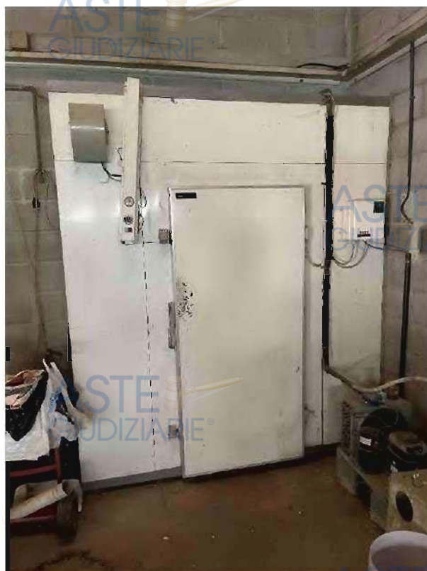
Figura 42 - cella frigorifera capannone
