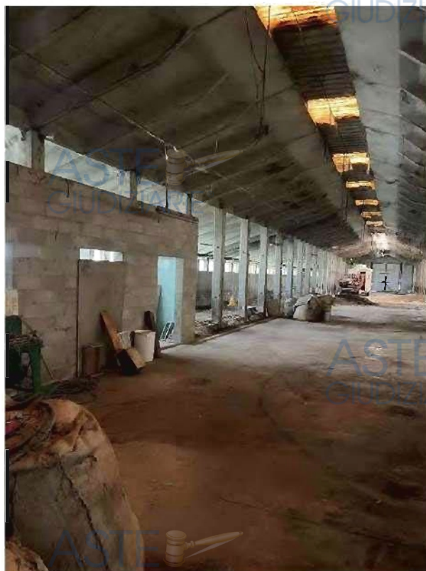
Figura 40 - vista area allevamento cunicolo con evidenziata parte abusivo non risultante catastalmente
