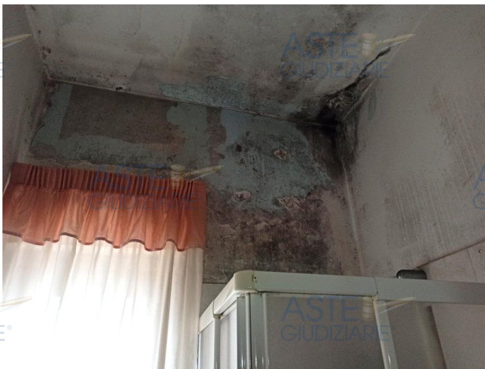
Foto n° 8 (interno abitazione – soffitto bagno 2)
