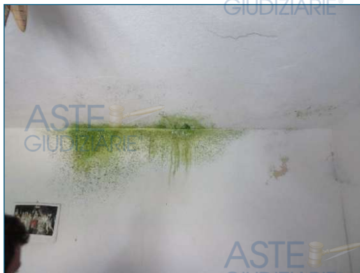
Infiltrazioni all'interno dell'abitazione
