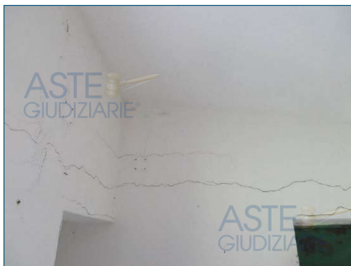
Lesioni all'interno dell'abitazione
