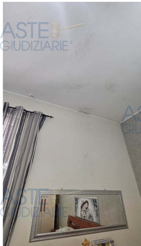
Foto n. 29: umidità camera matrimoniale
