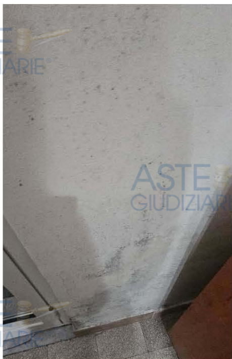
Foto n. 24: tracce di umidità in camera da letto
