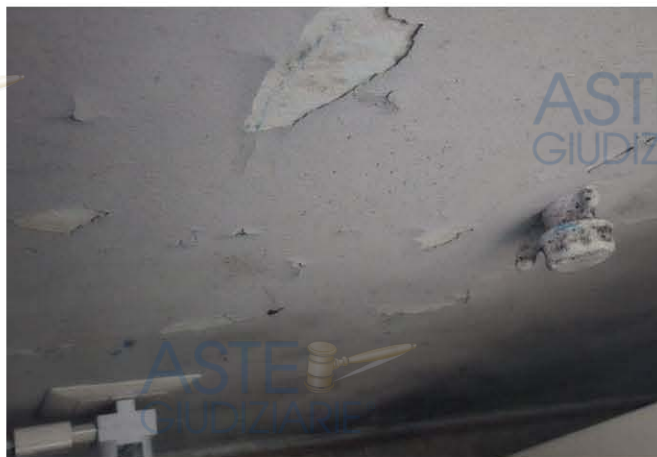
Foto n. 25: tracce di umidità nella cameretta
