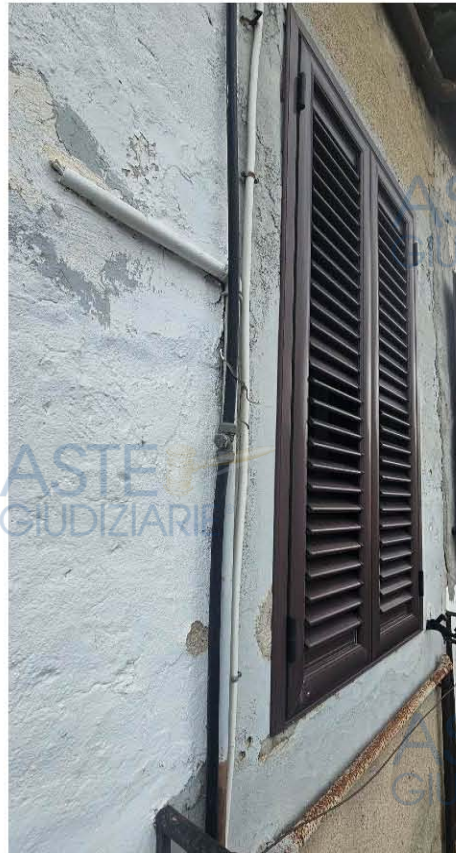
Foto n. 27: degradi su prospetto via Re Tancredi
