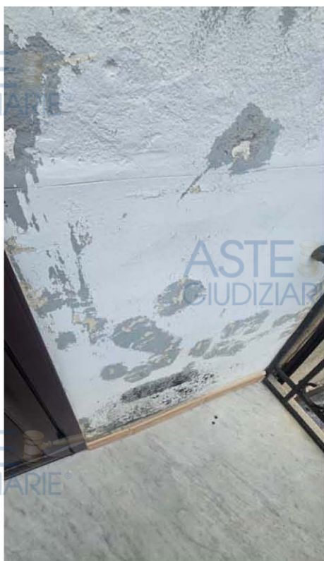
Foto n. 28: degradi su prospetto via Re Tancredi
