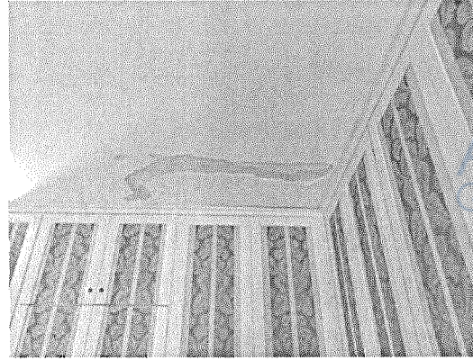
d) Porzione di solaio degradato
