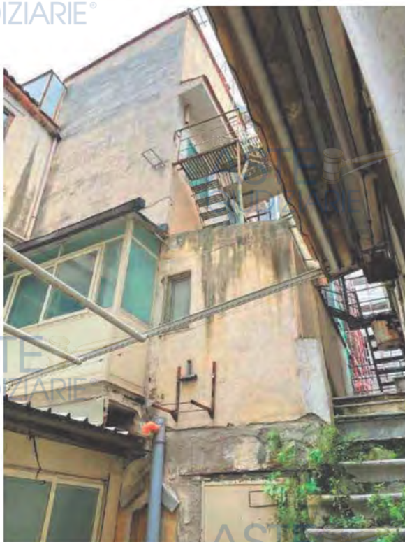
Sopraelevazione abusiva 2°-3° piano
