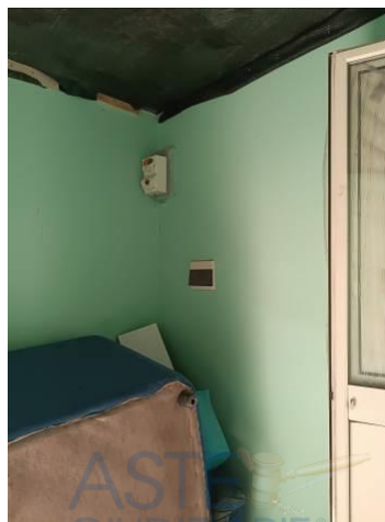
Fig. 38 Contatore e quadro elettrico.
