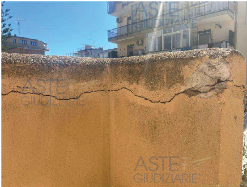
Foto n. 17 - Lesione sul muro del terrazzo
