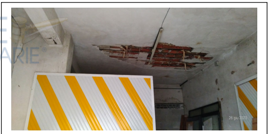
Foto 17. Interno del bene pignorato. Intradosso del solaio sfondellato
