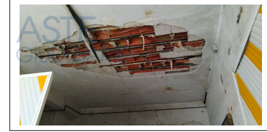
Foto 18. Interno del bene pignorato. Intradosso del solaio sfondellato
