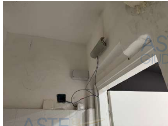
Foto n. 12 – cavi elettrici fuori traccia sub. 72
