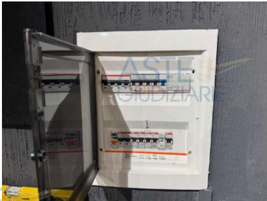
Foto n. 11 – quadro elettrico sub. 72
