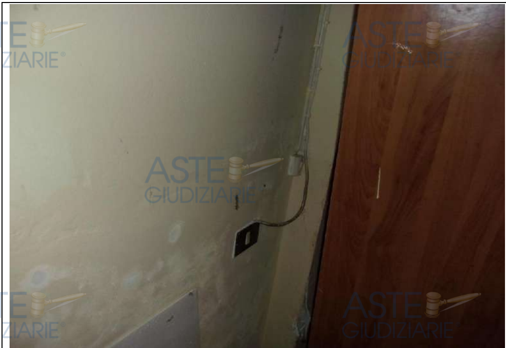
infiltrazioni da perdita cisterna ed impianto elettrico
