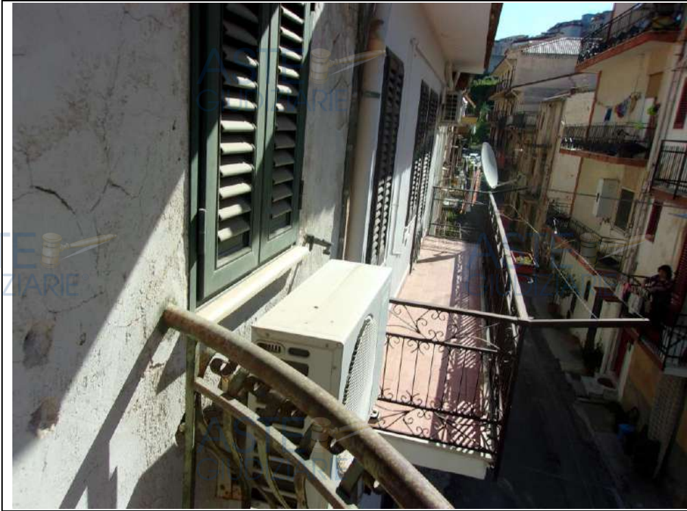
impianto esterno climatizzatore
