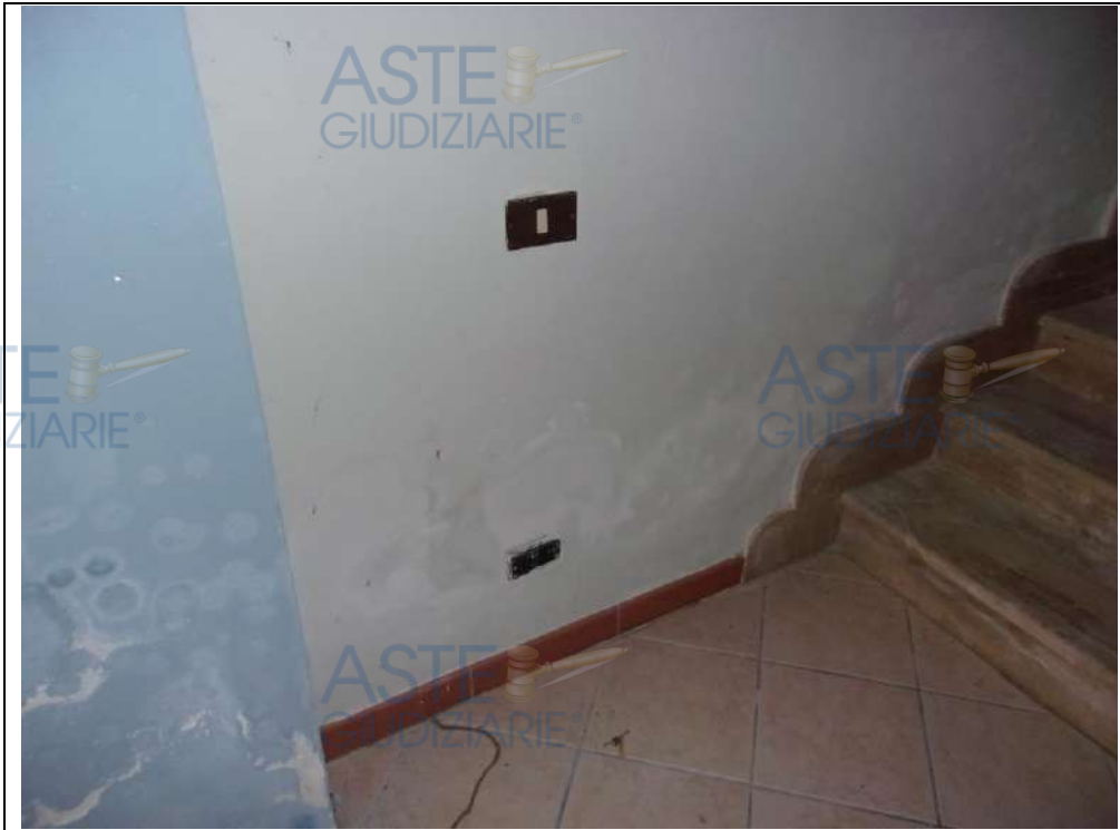
infiltrazioni da perdita cisterna ed impianto elettrico
