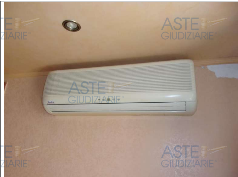
impianto interno climatizzatore
