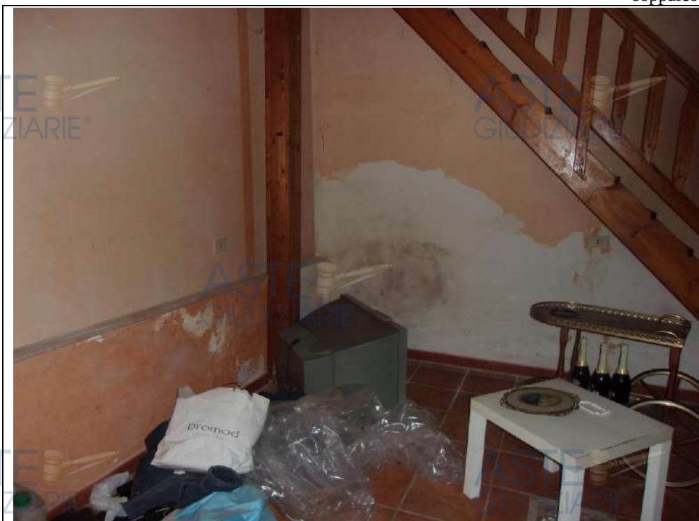
tracce di umidità piano terra
