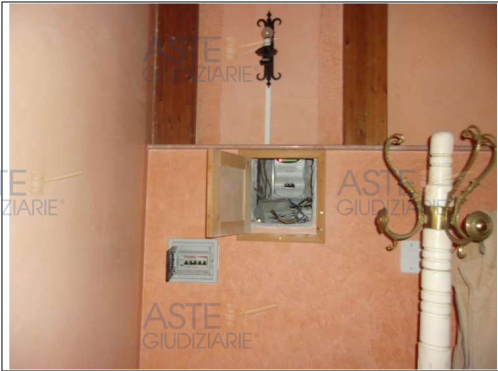
linea accesso impianto elettrico
