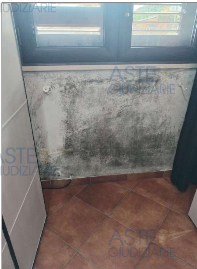
Camera da letto n.3. Muffa parete esterna esposta sud-est, sottofinestra.. Rif. 9 in planimetria.
