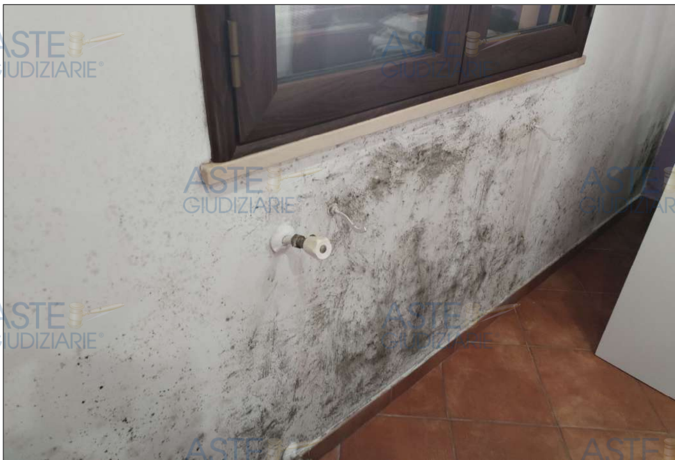
Camera da letto n.2. Muffa parete esterna rivolta a sud-est, sottofinestra. Rif. 6 e 7 in planimetria.
