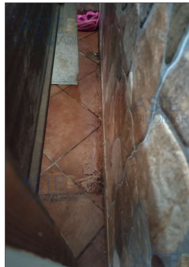
Cucina-soggiorno. Acqua pavimento parete esterna lato sud-est. Rif. 12 in planimetria.
