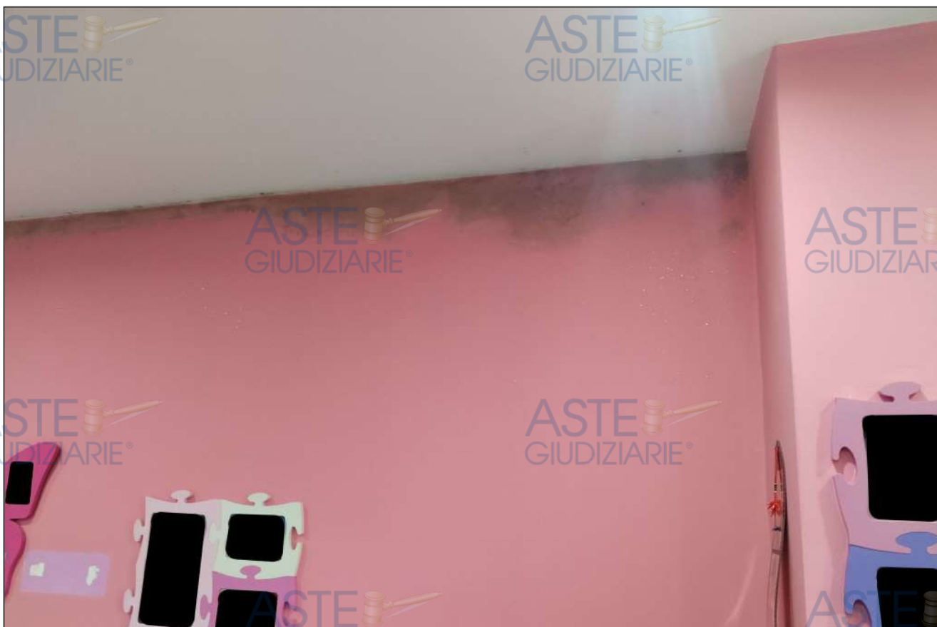
Camera da letto n.2 Muffa parete esterna rivolta a nord-est, giuntura soffitto. Rif. 5 in planimetria;
