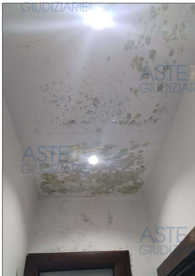
Bagno camera matrimoniale. Muffa soffitto. Rif. 4 in planimetria.
