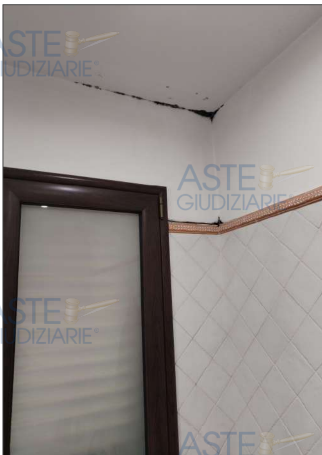
Bagno principale. Muffa parete esterna esposta nord-est, giuntura soffitto.. Rif. 11 in planimetria.
