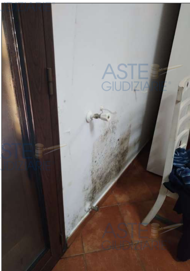
Camera da letto matrimoniale. Muffa parete esterna rivolta a nord-est. Rif. 3 in planimetria.
