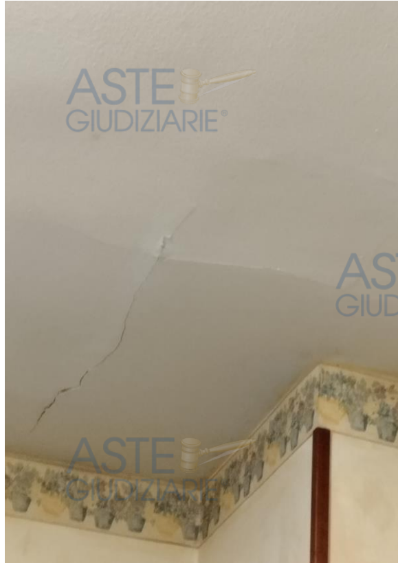
Infiltrazione proveniente da piano superiore
