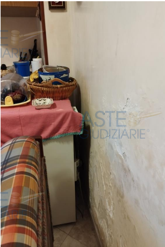
Danni da infiltrazione d'acqua – sogg/cucina
