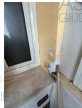
Infiltrazione di umidità dall'infisso veranda
