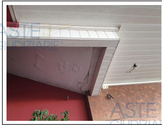
Foto n. 33 – lesioni e rigonfiamenti dell'intonaco dell'intradosso della scala
