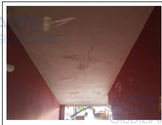
Foto n. 34 – lesioni e rigonfiamenti dell'intonaco dell'intradosso della scala
