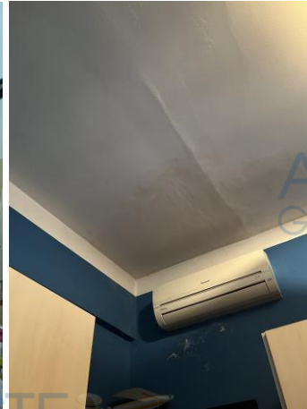
Foto 18-Ammaloramento su intradosso di solaio piano primo- Camera 2
