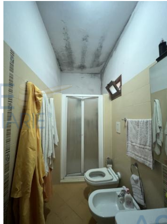
Foto 17-Ammaloramenti su intradosso di solaio piano primo- wc1
