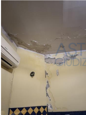
Foto 16-Ammaloramenti su intradosso di solaio piano primo- cucina
