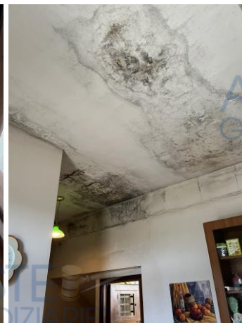
Foto 15-Ammaloramenti su intradosso di solaio piano secondo
