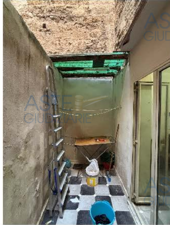
Foto n. 14 – Pozzo luce su retroprospetto
