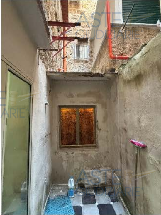
Foto n. 13 – Pozzo luce su retroprospetto
