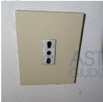
Particolare dell'impianto elettrico.
