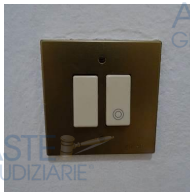
Particolare dell'impianto elettrico.
