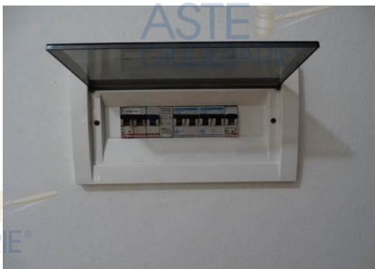
Quadro elettrico dell'appartamento.
