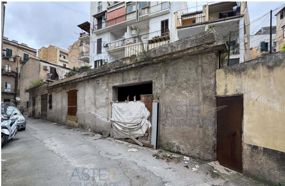
Foto n. 3 - l'immobile costituito dal solo piano terra, veduta su strada. L'ingresso privo di infisso o saracinesca è chiuso con tavole di legno e teloni. L'edificio presenta l'intonaco ma non la finitura.
