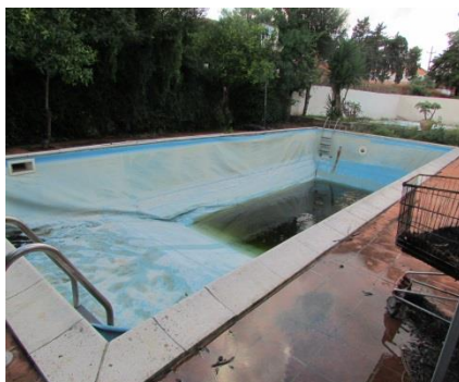
- Piscina su pertinenza (abuso).
