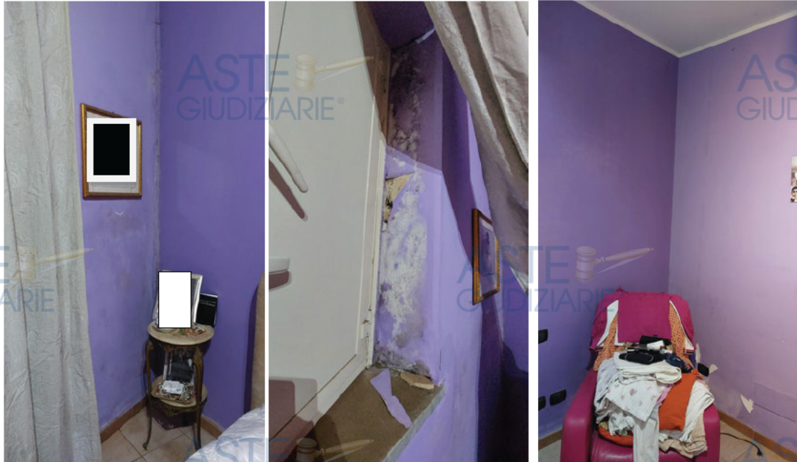
Foto 7 – 8 – 9: Camera da letto piano terra – Tracce di umidità e muffe
