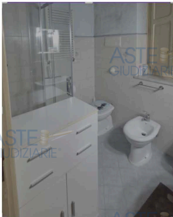
Foto 6: wcd con finestra sulla corte. Visibili effetti di condensa sulle pareti (ed anche sul soffitto)
