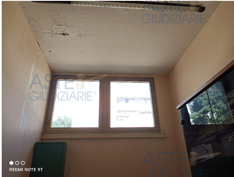
Porzione del soffitto danneggiata
