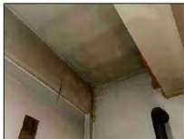
Fig.34 Umidità sul soffitto del soggiorno
