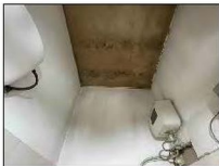
Fig.35 Umidità e muffe sul soffitto del bagno
