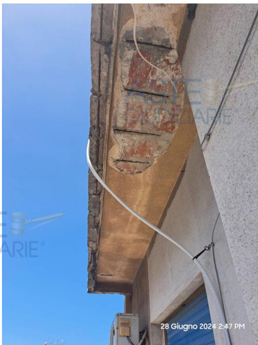
Degrado sul cornicione
