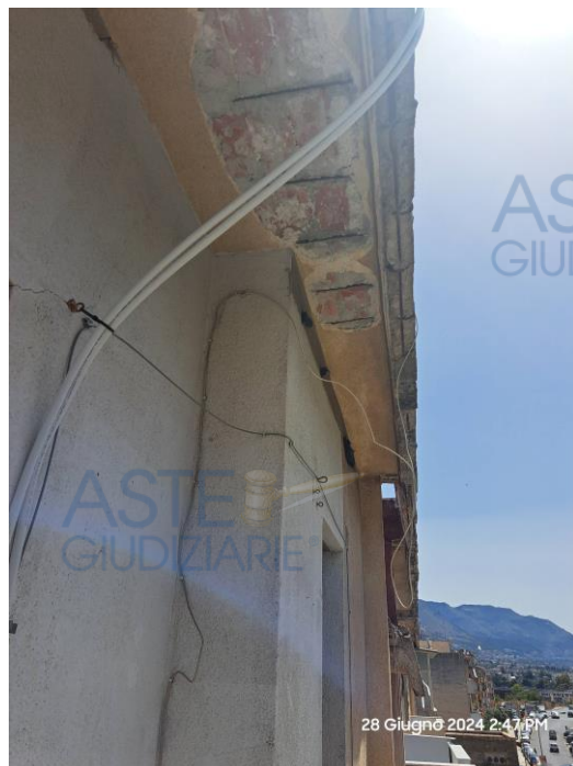
Degrado sul cornicione
