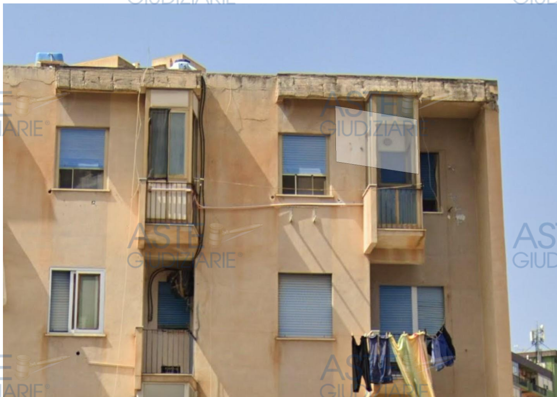
Degradi sul cornicione e sui balconi
