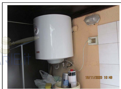
Foto 23. Scaldacqua elettrico ubicato nel corpo edilizio adibito a ripostiglio/lavanderia
