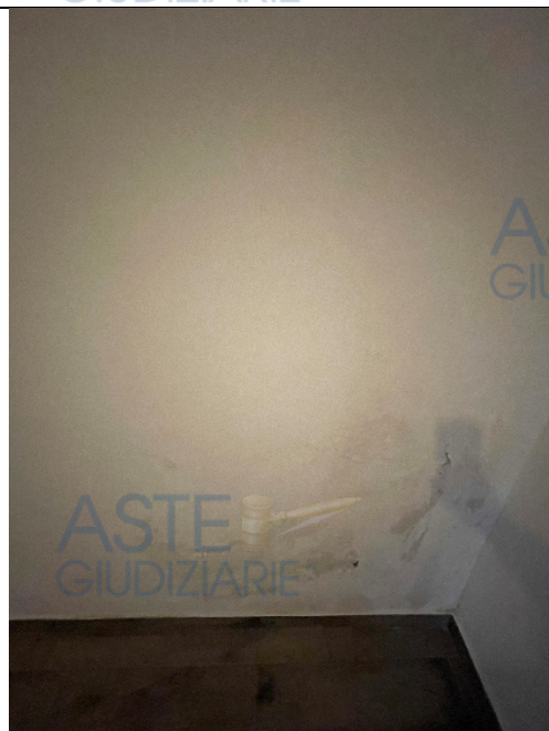
Umidità piano scantinato sub 2
