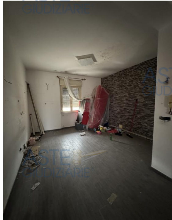
Foto 6 – Il salotto: sul soffitto macchie di umidità
