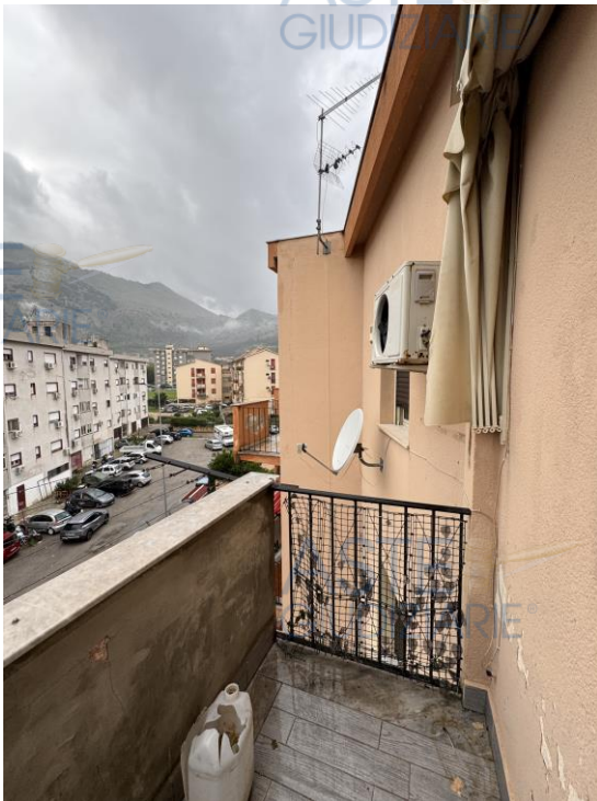
Foto 7 – Il balcone della camera matrimoniale: il muro esterno e il parapetto sono interessati da infiltrazioni.
