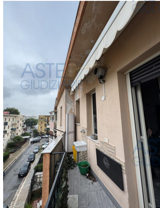
Foto 8 – Il balcone a cui si accede dalla cucina: il muro esterno è interessato da infiltrazioni.
