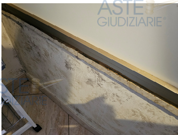
Macchie di muffa diffuse nel parapetto della veranda
