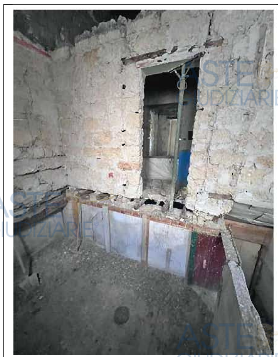
Foto n. 40-41. Immobile identificato al sub. 15 in cui è crollato il solaio di calpestio
