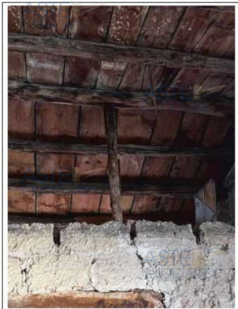
Foto n. 37. Particolare della copertura lignea con puntello di sostegno
