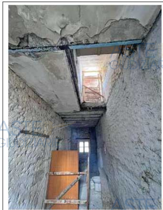
Foto n. 27-28. Scala comune con accesso da Piazza Linates n. 6. Rampa che conduce all'immobile identificato al sub. 16 al secondo piano. E' visibile l'ingresso alla terrazza del terzo piano non accessibile per l'assenza dell'ultima rampa
