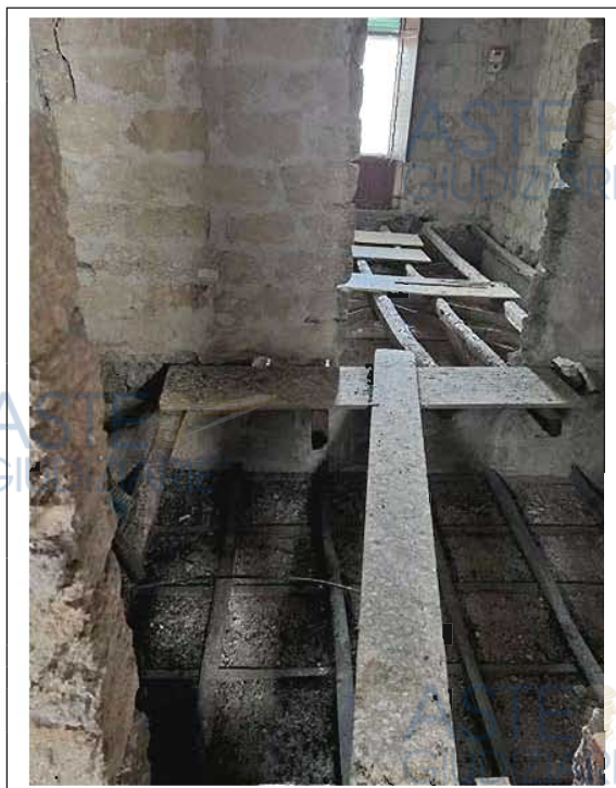
Foto n. 44-45. Immobile identificato al sub. 14 in cui è crollato il solaio di calpestio
