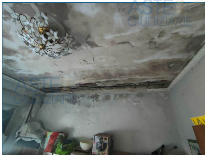
Condizione del soffitto della prima camera
