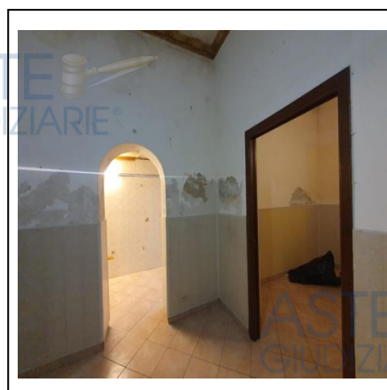
Foto n. 12 tracce delle infiltrazioni umide
