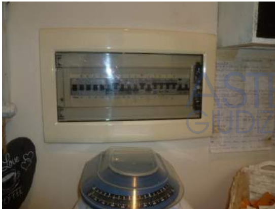
Fig. 23 Quadro elettrico (ubicato nella lavanderia).
