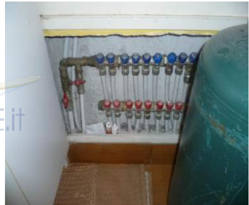
Fig. 24 Collettore idrico (ubicato nella lavanderia).
