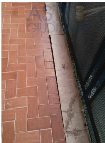
pavimentazione del balcone con marmi staccati
