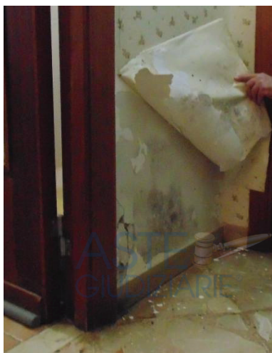
Parete con muffa e distacco di intonaco
