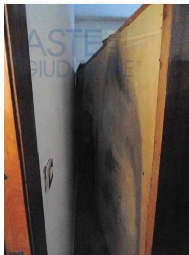
il dietro armadio ammuffito per perdita acqua del bagno
