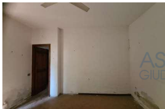
Foto n. 14 Ingr./salone – macchie di umidità lungo le pareti
