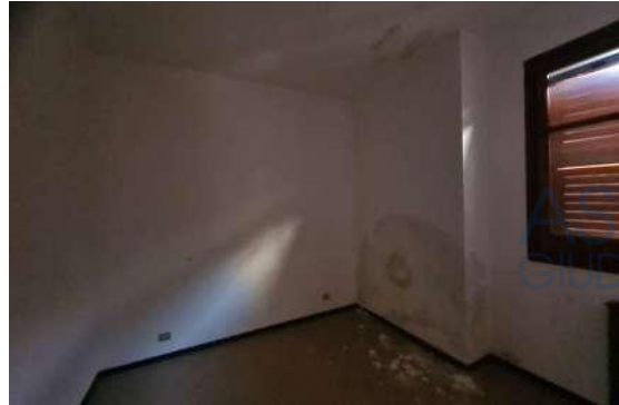
Foto n. 53 Vano letto singolo-Tracce di umidità
