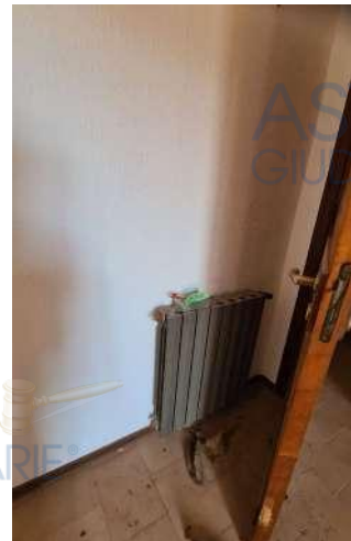
Foto n. 59 Vano letto Pannello radiante in ghisa
