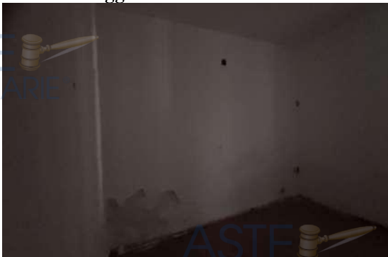
Foto n. 23 Soggiorno - macchie di umidità
