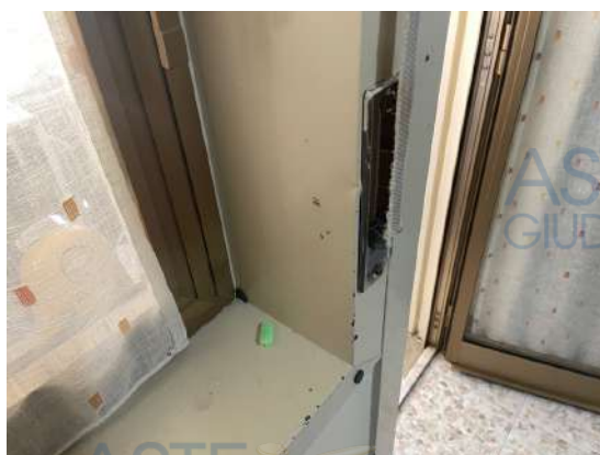
Foto n. 16 – mancanze nella verniciatura
