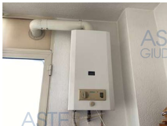
Foto n. 14 – caldaia a gas
